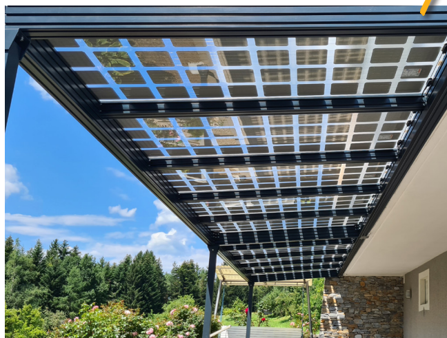
Terrasse LEA10 (2.5 kWp)
